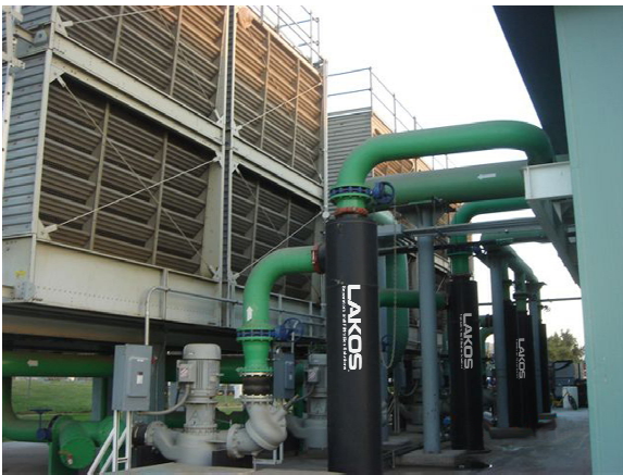
冷却塔清掃システム(循環式)
